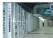
储存环内技术走廊
