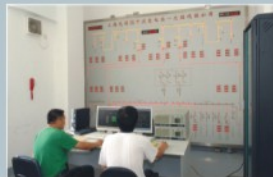
35kV变电站中央控制室
