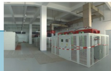
35kV变电站高压柜和变压器
