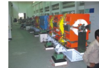
储存环单元试安装
