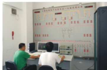
35kV变电站中央控制室
